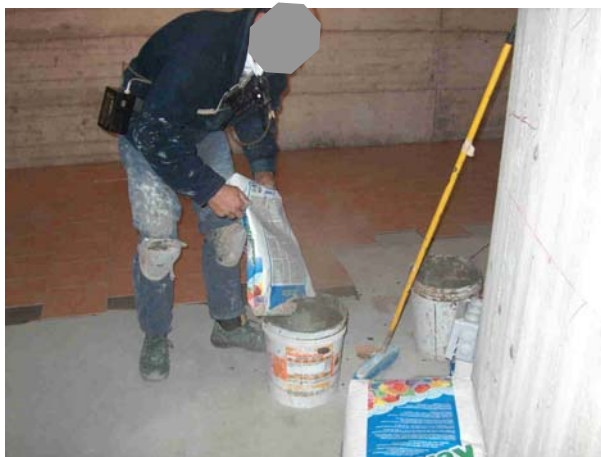
Sversamento prodotto adesivo pre-miscelato
